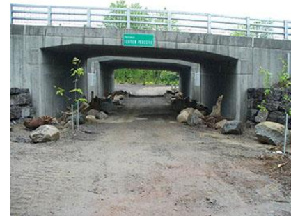
Passage faunique urbain sur le boulevard Robert-Bourassa dans le secteur Lebourgneuf à Québec (parc de l'Escarpement) © Transport Québec
